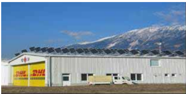
Slika 18: Sončna elektrarna Flycom Radovljica 16,3 kW, zgrajena leta 2005
